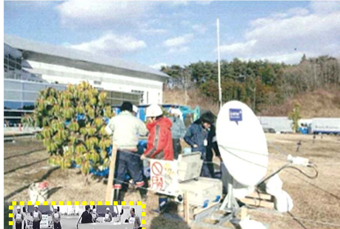
非常衛星通信用 パラボラアンテナ電源
